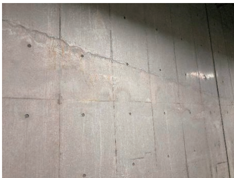
写真1 コールドジョイント
