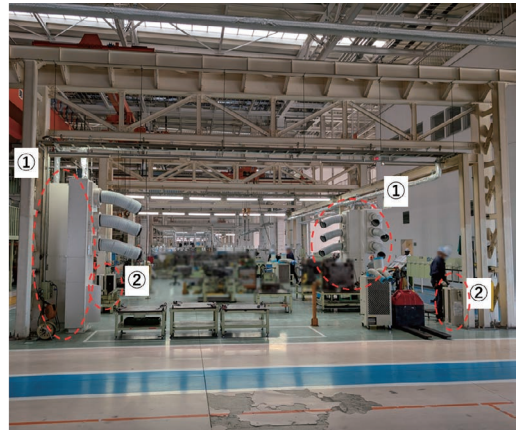
Fig.2 ゾーン空調エリア設置風景、① 空調ユニット、② エアカーテンユニット
