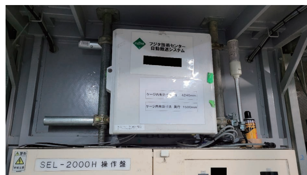
写真 4 エレベータ自動化装置の構成
