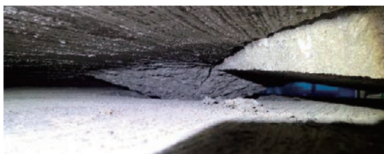
写真2 打継面アンカー材付近の破断状況
