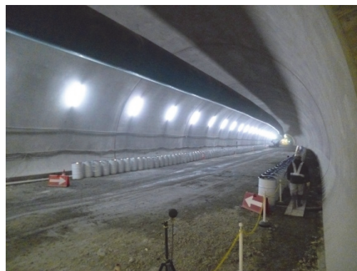
写真4 坑内設置状況-2
