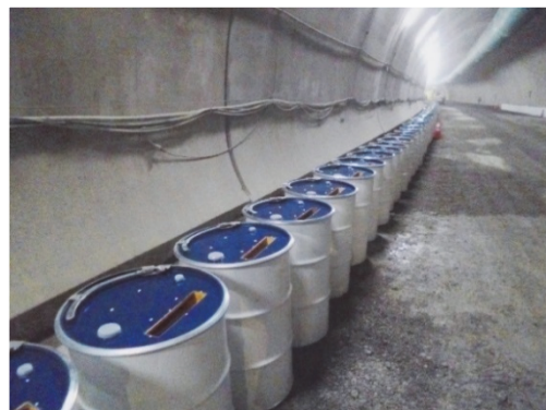
写真3 坑内設置状況-1
