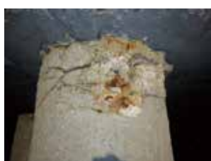
杭頭部の曲げ破壊
