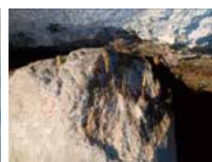
杭頭接合部のずれ破壊
