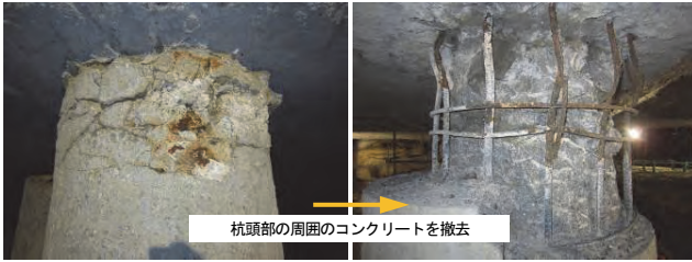
写真 2 杭頭部の曲げ破壊(A-6)
