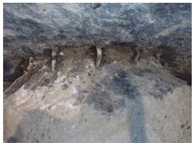
写真1 杭頭接合部の曲げ破壊 (B-5)
