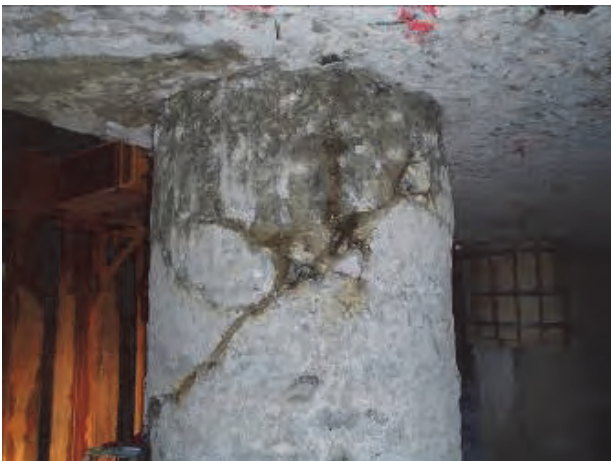
写真 5 杭頭部の曲げ破壊とせん断破壊の複合(D-7)
