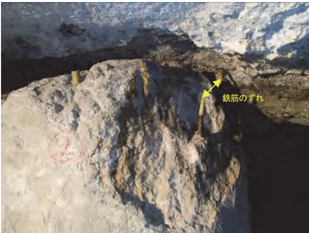
写真 4 杭頭接合部のずれ破壊(Z-6)
