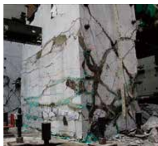
補修試験体(No.1R) 最終破壊状況
