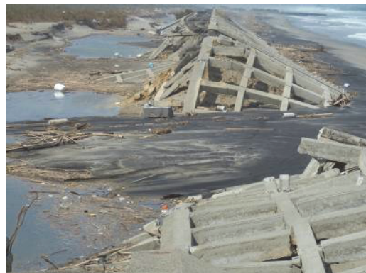
写真1 津波により破壊された海岸堤防
