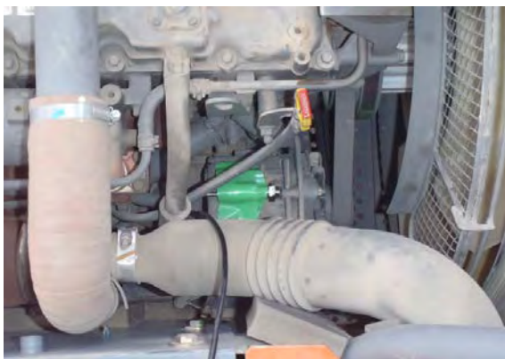
写真4 エンジン回転数検出器の設置状況
