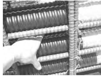
写真 2 PC 橋のシース管周辺の状況
