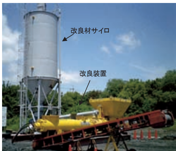
写真 1 琵琶湖浚渫土の土質改良装置
