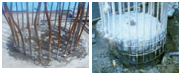
写真1 杭頭部でのコンクリートの不良
