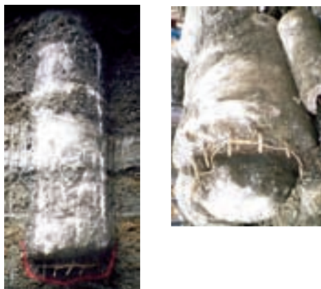
写真2 杭先端部のスライムによる断面の欠如
