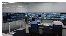
遠隔監視センター
