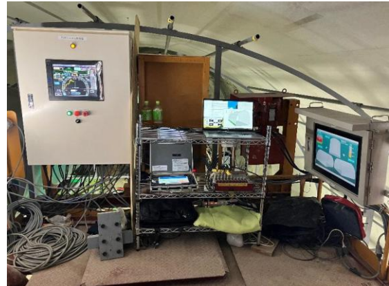
セントル上部の各種制御盤
